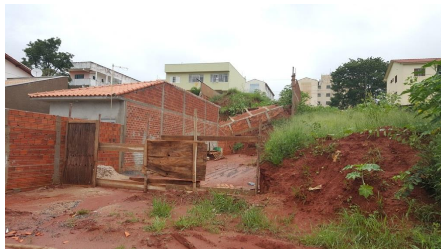
Deslizamento do Muro
