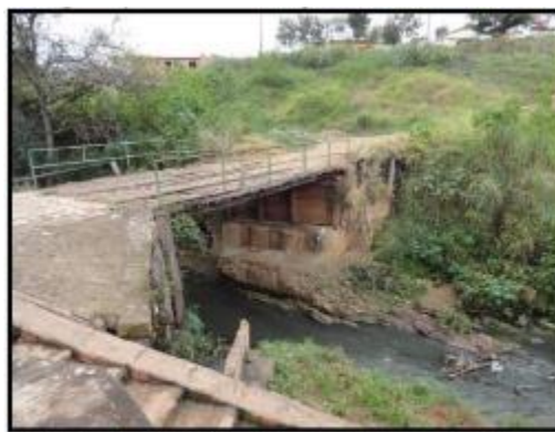
Ponte próxima à moradia. Notar o afloramento de rocha na base da fundação da ponte e o assoreamento por solo, entulho e lixo.
