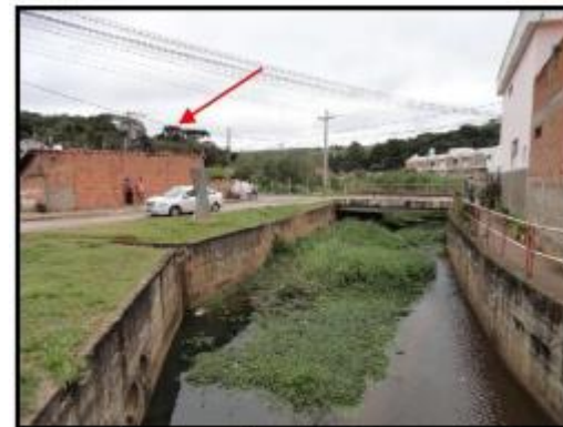
Vista da moradia atingida, quando da ocorrência de inundações, no trecho canalizado do córrego Aranha. Notar o assoreamento por solo e vegetação.
