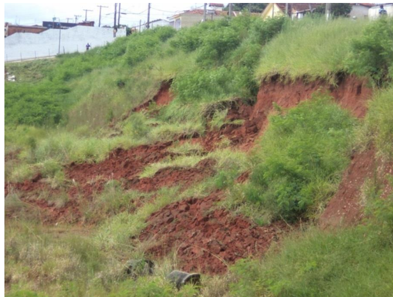
Deslizamento de Massa
