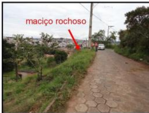
Vista geral da área IPV-05, na Rua São Benedito. Notar a inclinação da encosta e a moradia que poderá ser afetada, quando da ocorrência de queda de blocos.
