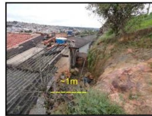
Detalhe da distância dos fundos das casas em relação ao maciço rochoso.
