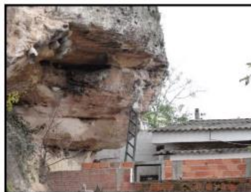
Detalhe da proximidade da casa com o paredão rochoso. Observar a cavidade na rocha.
