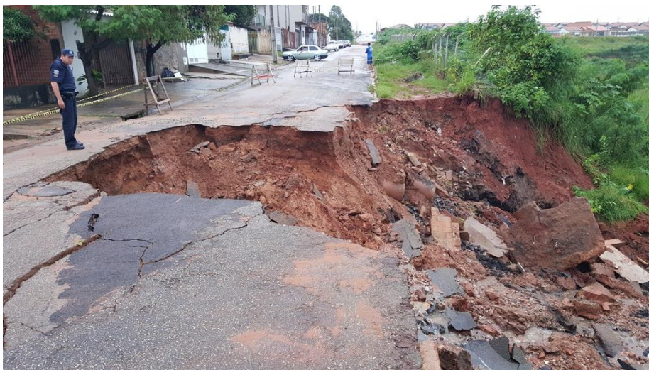
Deslizamento de Massa
