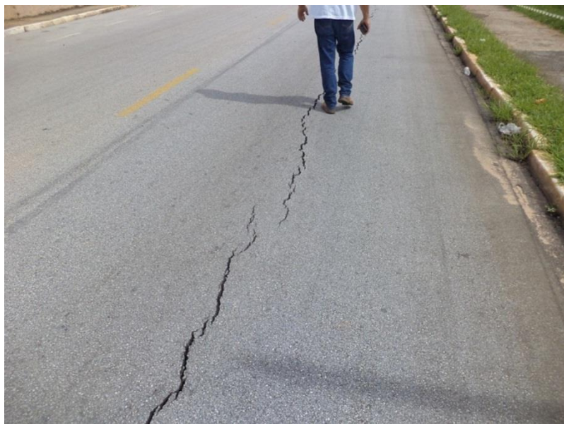
Fissura no Asfalto
