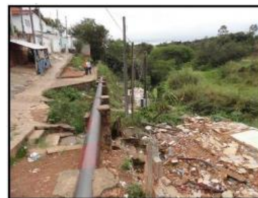
Vista para a jusante dos escombros das duas moradias demolidas, relacionado ao risco de solapamentos na margem esquerda do córrego Aranha.
