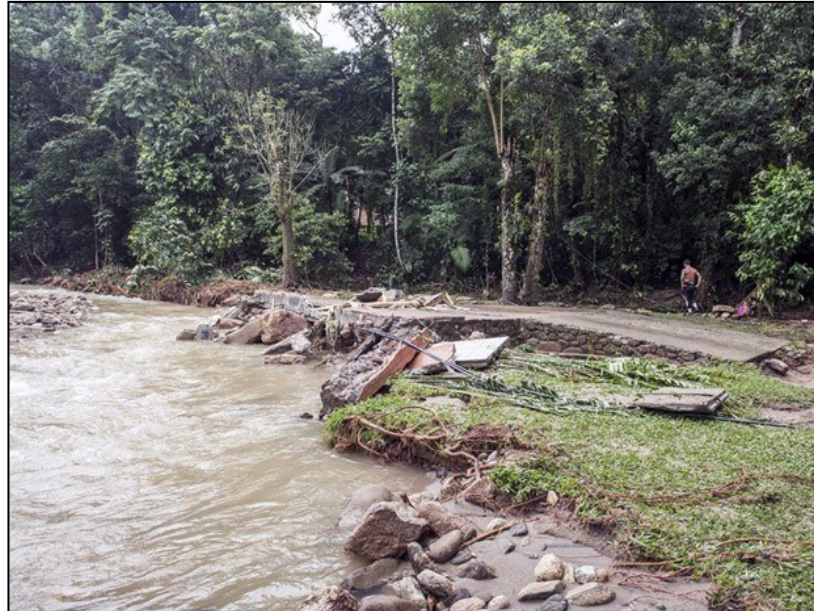
Figura 13 – Danos causados por enxurrada.
