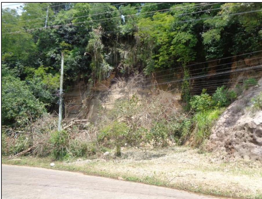
Figura 30 – Material depositada de evento de queda que ocorreu em 13/10/2022.
