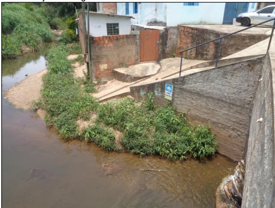
Figura 43 – Observar o assoreamento no córrego Aranha e a placa de área sujeita a alagamento.
