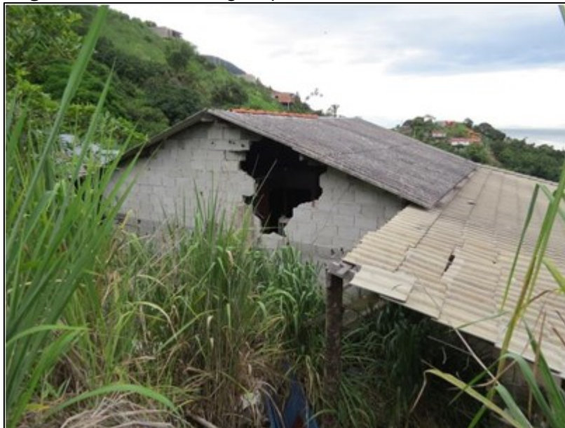
Figura 4 – Moradia atingida por bloco rolado da encosta.
