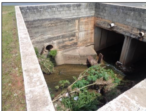
Foto 12 – Detalhe das interferências presentes no curso d'água, tubulação de esgoto que retém material.
