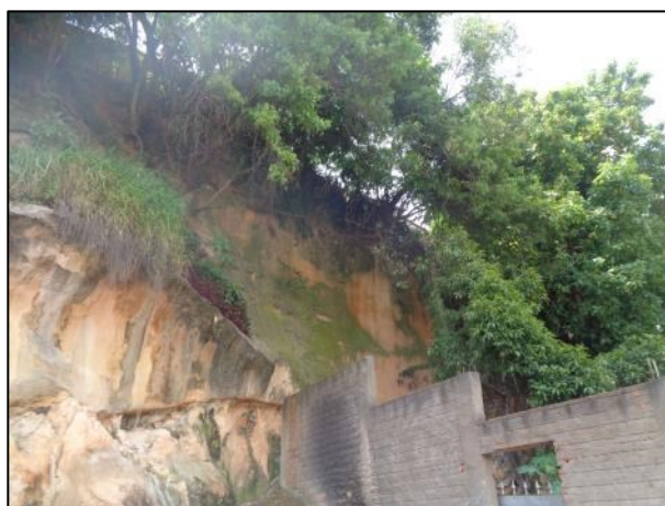
Foto 16 – Detalhe do talude rochoso. Observar as fraturas e as árvores de médio porte com as raízes expostas.
