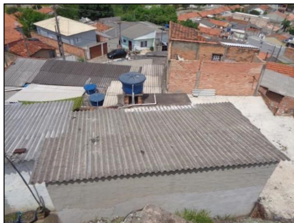
Foto 14 – Observar a proximidade da moradia com a base do talude rochoso.
