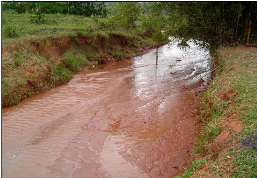
Figura 6 – Taludes marginais sujeitos a erosão.
