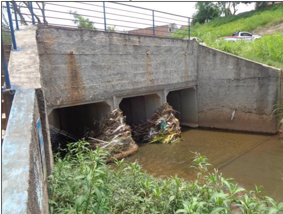
Figura 45 – Acumulo de lixo e galhos de árvores entre as aduelas.
