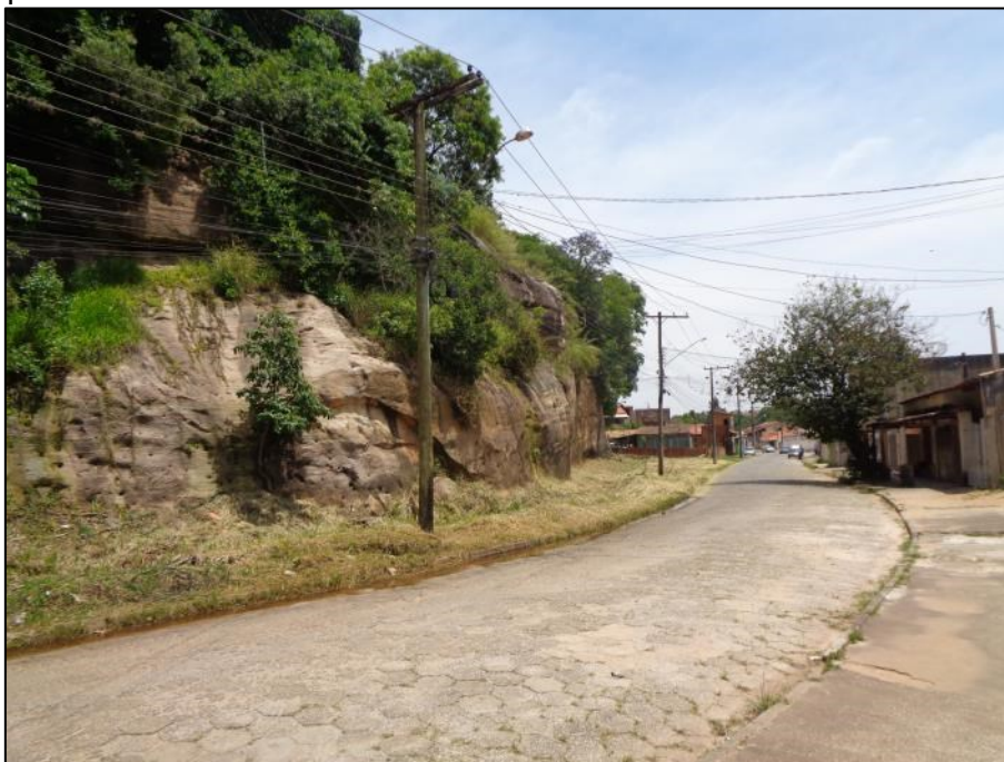
Figura 27 – Vista parcial do setor. Notar a via em bloquete e o paredão rochoso.
