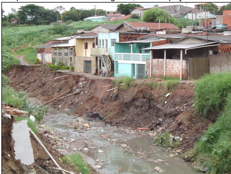
Figura 7 – Situação de risco associada a erosão e solapamento dos taludes marginais, com ocupação ribeirinha.
